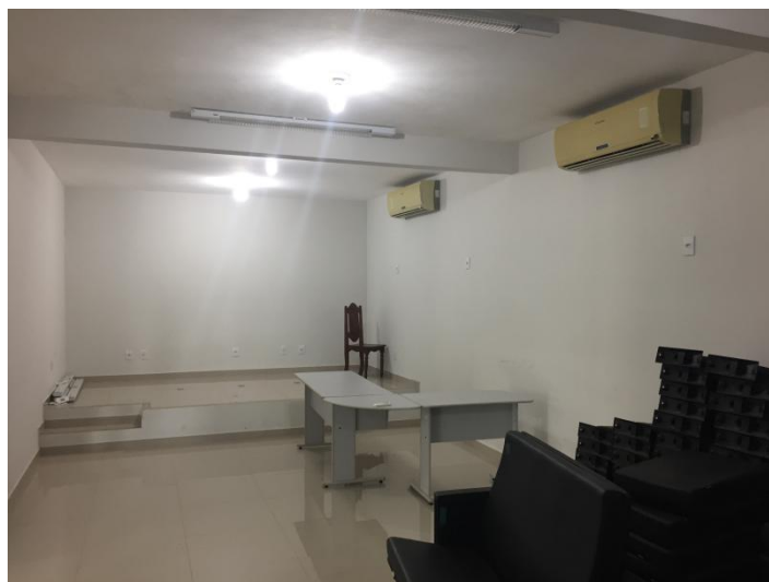
Figura 06: Lâmpadas queimadas; Lâmpadas substituídas por outras de menor luminosidade; Posição errada das tomadas de corrente para os aparelhos de ar condicionado.
