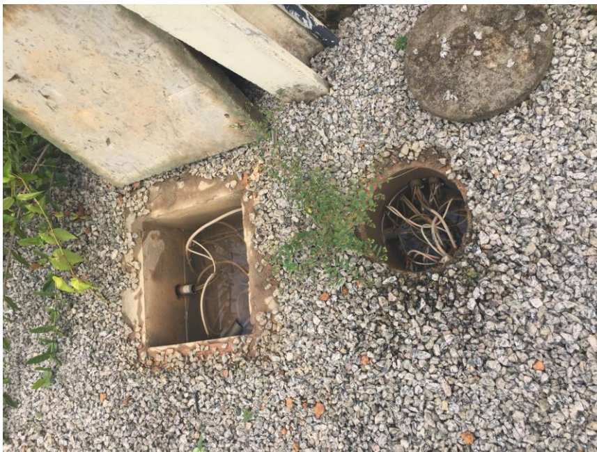
Figura 04:Emendas no alimentador principal, possivelmente ocasionando fuga de corrente para o aterramento
