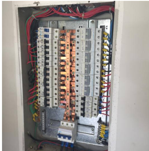
Figura 05: Quadro de distribuição sem proteção contra surtos, sem circuito trifásico para a alimentação da central de 60000BTUs, sem DRs para os chuveiros.
