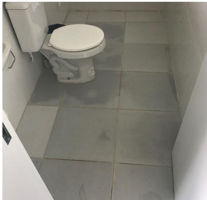
Figura 02: Piso dos banheiros apresentando patologia por infiltração, o que vem acarretando mudanças visuais.
